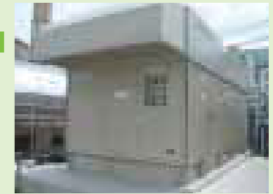
天然ガスコージェネレーション施設
